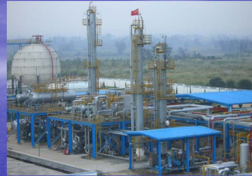
Mini LNG Plant
